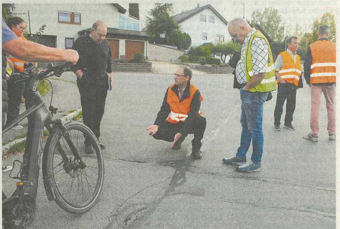
„Hier lassen sich schon die ersten Steine lösen!“ Dauchingens Bürgermeister Torben Dorn erklärt einen Schaden in der Schwarzwaldstraße.
